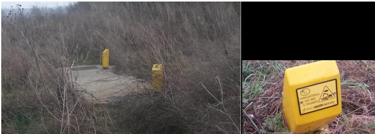
Conduite de gaz avec bornes de repérage
